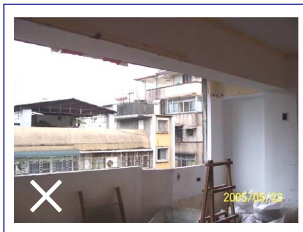
▲ 擅將外牆拆除「陽臺外推」係屬違建行為。
