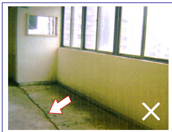
▲ 擅自拆除陽臺外牆，導致陽臺根部開裂之案例
