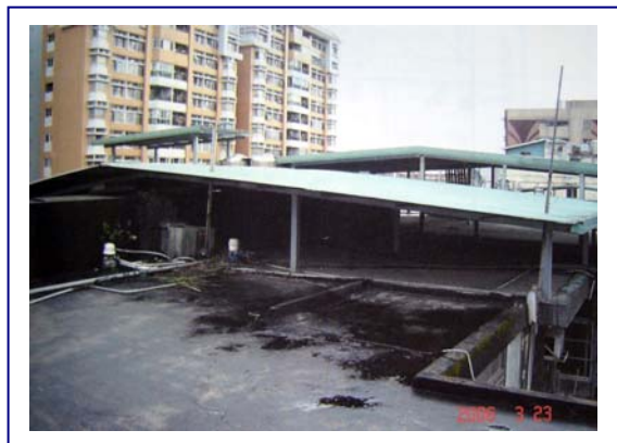
▲ 老舊、漏水建築物得申請於屋頂版上加蓋一定規模以下的斜屋頂。
