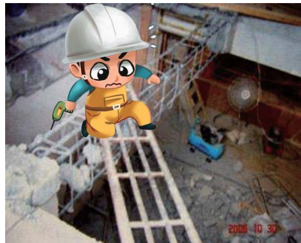
未經登記許可的非法業者進行室內裝修施工，可能陷於設計錯誤及破壞主要構造
