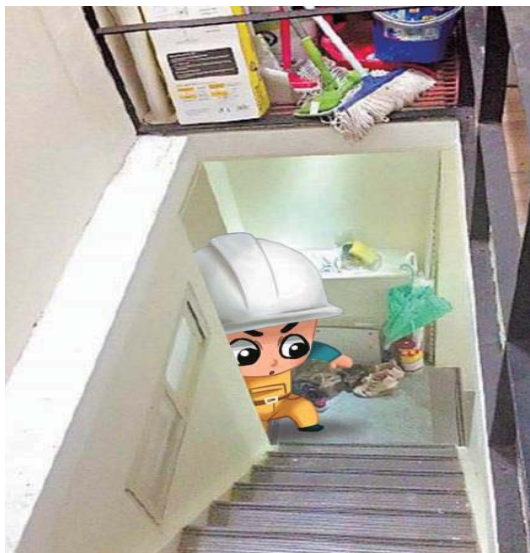
分租套房因人口複雜，容易造成公共空間堆雜物而影響逃生動線
