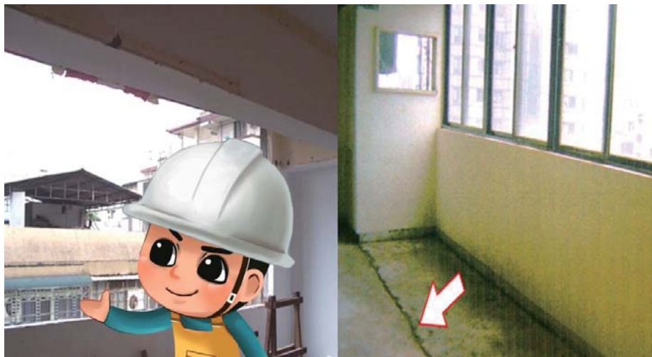
大多數陽台均採用懸臂式結構設計，擅自拆除陽台外牆，日久將導致陽台的根部開裂，嚴重者甚至會發生陽台坍塌或掉落
